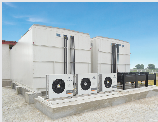
Stazione di atterraggio cavi prefabbricata Abidjan, Costa d'Avorio
