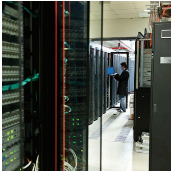
Carga de calor de la sala: 350-400 W/ft 2
