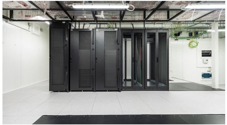
À l'intérieur du module préfabriqué Vertiv
