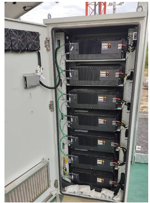
Gabinete externo Vertiv™ EPC 48300/2900 com baterias de íon-lítio
